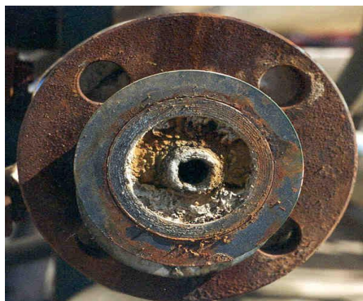
Figure 7: Corrosion of tubes (Kagel A., 2008).
