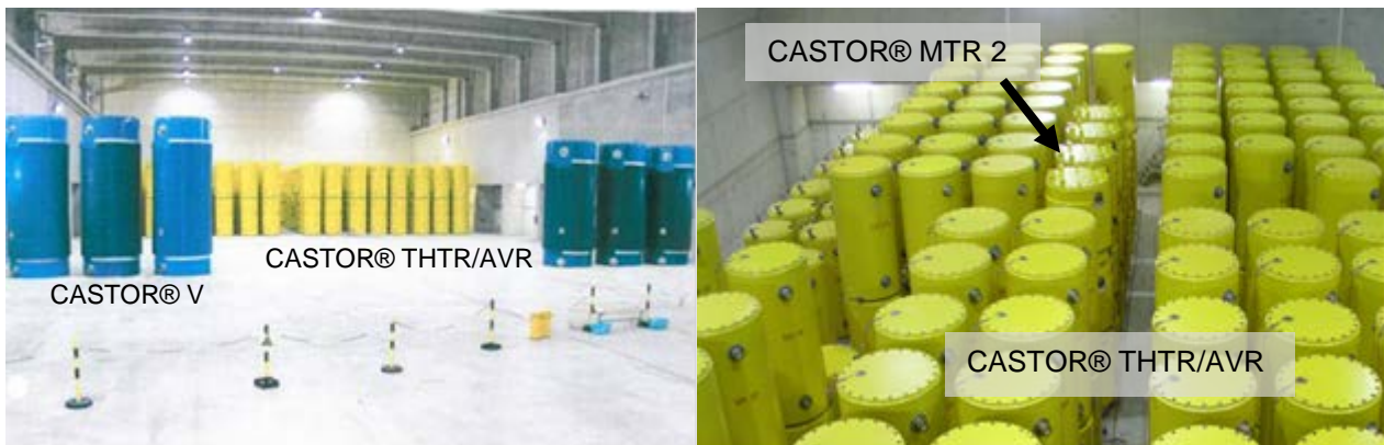
Abbildung D-5: Transportbehälterlager Ahaus (Bildrechte: GNS) links: CASTOR® V und CASTOR® THTR/AVR rechts: CASTOR® MTR 2 zwischen CASTOR® THTR/AVR
